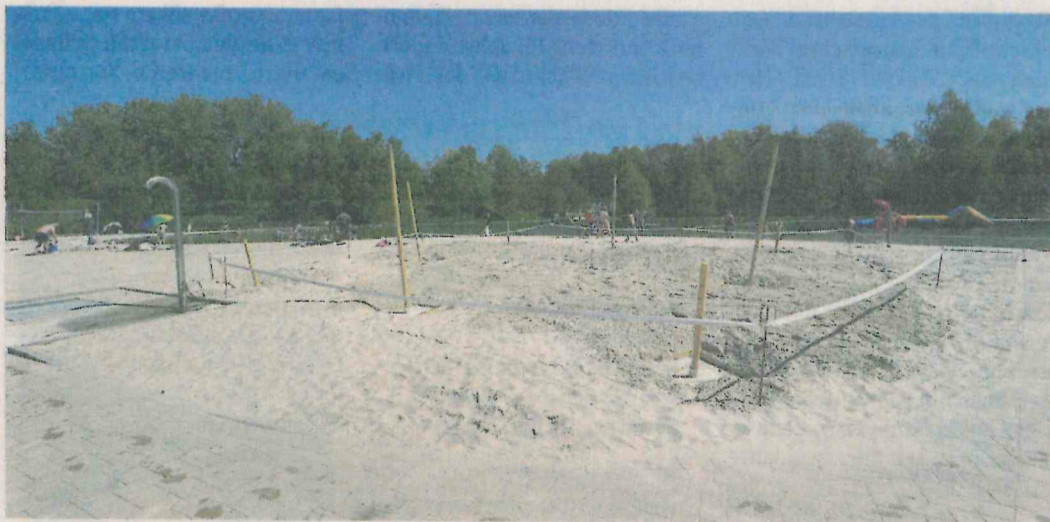
Die Vorbereitungen sind schon abgeschlossen, in wenigen Tagen soll über die Pfähle ein großes Segel gespannt werden, das für Schatten im Sandbereich sorgen soll.
